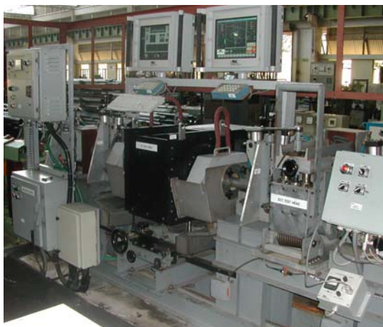
利用安装在高台上的Echomac超声波旋转式检测仪进行管材检测，利用退磁仪去除残留磁性，并利用MAC系列涡流环绕线圈进行检测。
